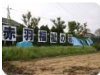
斜面が侵食しています
