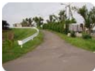
ひびが入り、路面がでこぼこしています
